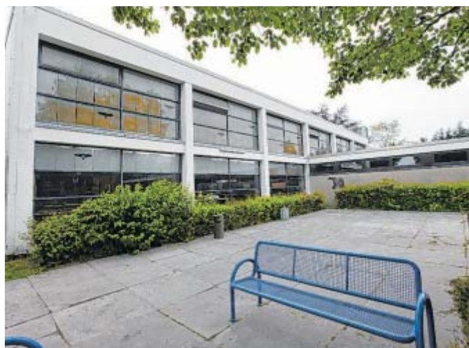
Reif für den Abriss: Die alte Turnhalle am Lüttfeld wird dem Bau für Mensa und Berufspraxisstufe weichen.
